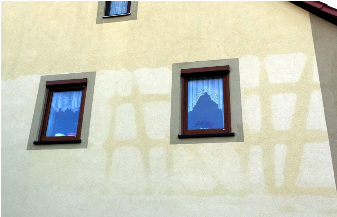
Abb. 1: Erstes Stockwerk eines alten Bauernhauses nach einem Regen
